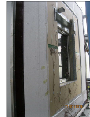
Figure 5: Montaggio sensori lato freddo.
