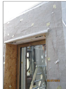
Figure 3: Montaggio sensori lato caldo
